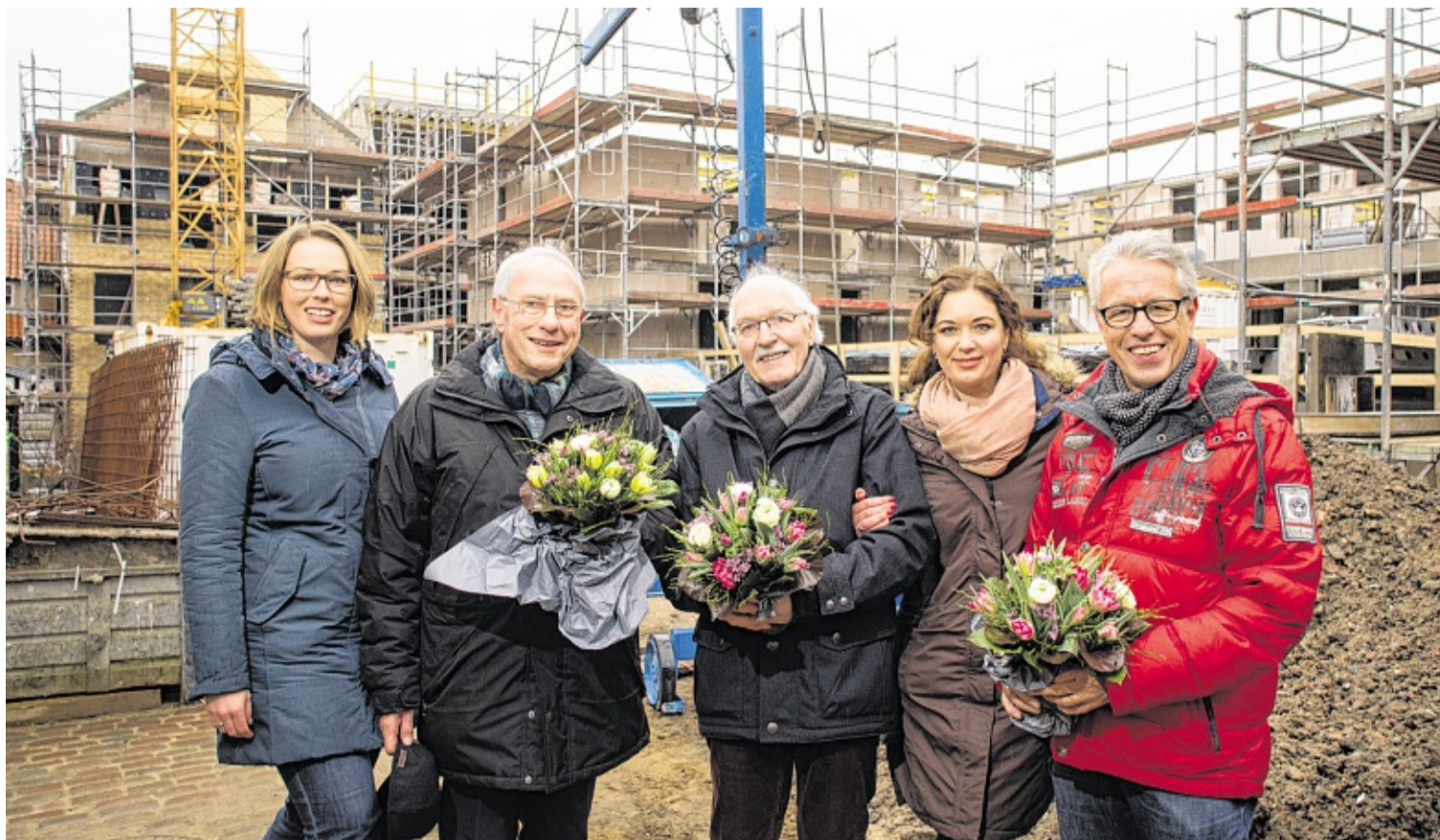
Blumen und Gutscheine für die Gewinner: Hanna Höft-Pfeiffer (l.) und Kirsten Herrmann (2.v.r.) mit Harry Rudow, Jochen Hackradt und Wilfried Oppermann (v.l.) auf der Baustelle des von ihnen benannten „Hotel Hafen Flensburg“.
